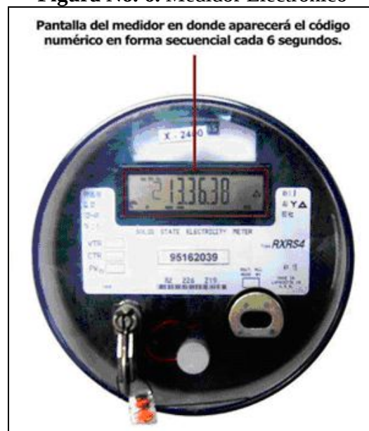
Figura No. 6. Medidor Electrónico
